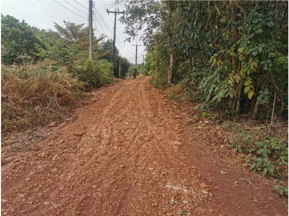
ภาพถ่ายการซ่อมแซมถนนลูกรังในพื้นที่ตำบลวังดาล
